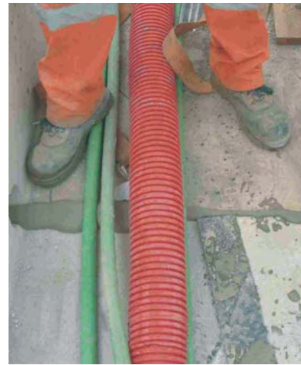
El HAC rebosa por la junta entre canaletas lo que garantiza un rellenado correcto.
